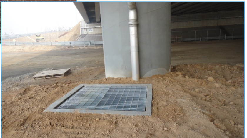
<仁川大桥 桥梁排水路的 集水井形 非点污染降减设备>
