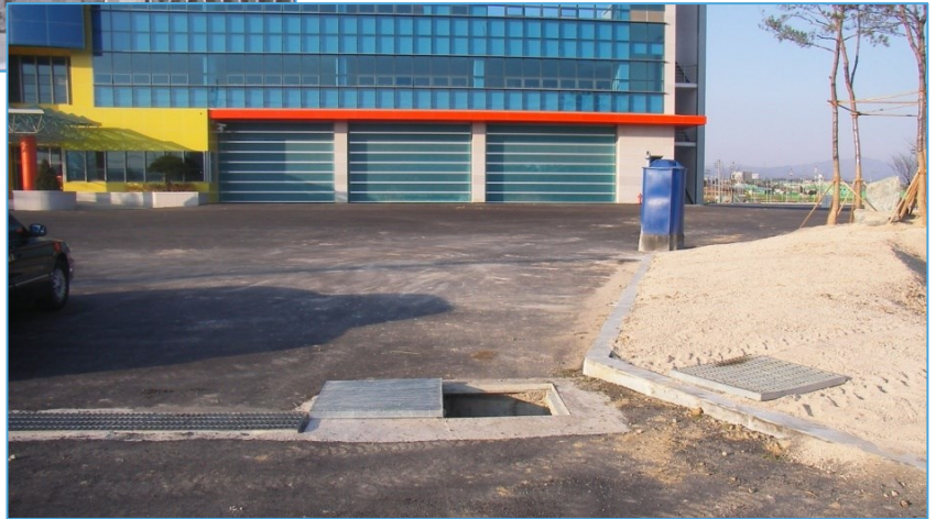
<영천소방서 신축지 집수정형 비점오염저감장치>
