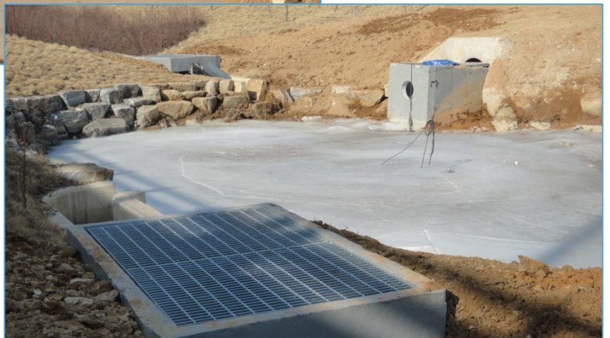
<인천대교 식생저류조의 집수정형 비점오염저감장치>
