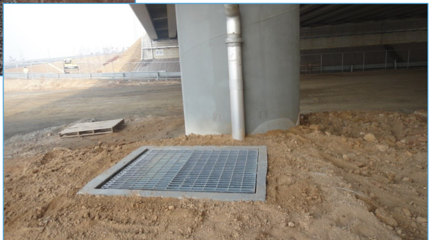
<인천대교 교량배수로의 집수정형 비점오염저감장치>
